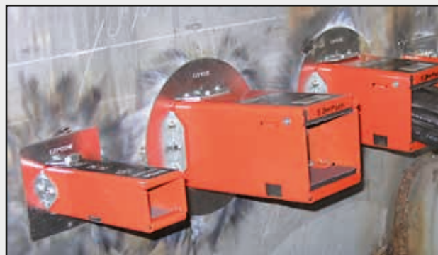
Particiones en pared metálica de prueba en WFRS
